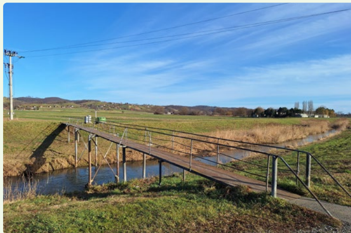
Slika 8: Brv čez reko Ledavo v Trimlinih predstavlja pomembno povezavo med levim in desnim bregom reke Ledave, vendar njeno trenutno slabo stanje zahteva nujno sanacijo ali zamenjavo zaradi varnosti pešcev in lokalne dostopnosti.
