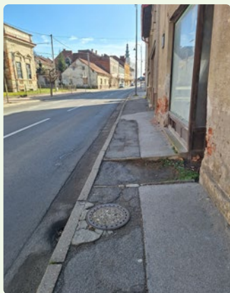
Slika 3: Neustrezno urejen pločnik z asfaltiranimi sanacijskimi flikami, izstopajočim revizijskim jaškom in višinskimi razlikami – ovira za varno uporabo s strani gibalno oviranih oseb
